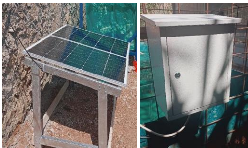
Gambar 4. Panel surya dan box sistem kontrol panel surya serta pompa untuk sirkulasi air kolam
