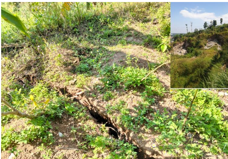
Gambar 6. Retakan permukaan tanah
