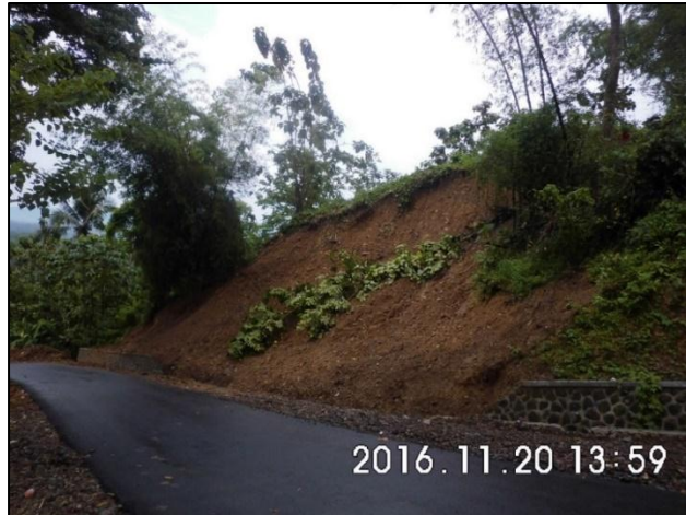
Gambar 2. Lereng LR-05A Yang Telah Mengalami Kelongsoran
