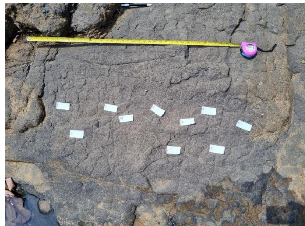
Gambar 18. Kenampakan kekar pada stasiun FY 6-1.
