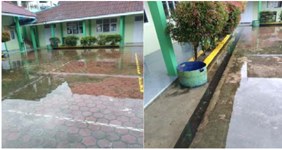
Gambar 1. Kondisi Genangan Air Di Halaman Sekolah Dan Genangan Air Di Depan Kelas
