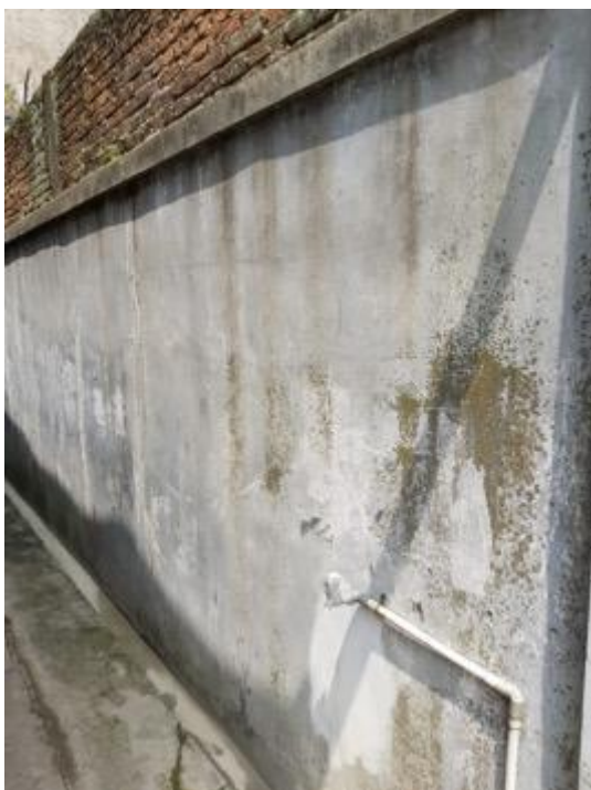
Gambar 2. Kondisi Awal Dinding Mural (Sumber:Dokumentasi Pribadi, 2024)
