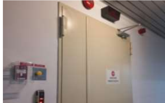
Gambar 2. Pintu Pertama Ruang Penyimpanan Server ANRI (Ladyasya, 2024)
